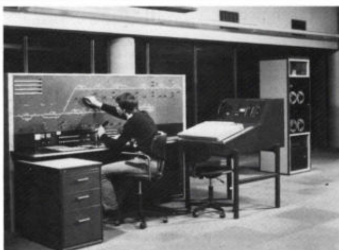
De eerste 22-kanaals voice logger is door Philips geïnstalleerd in het treinverkeersleidingscentrum te Groningen.
